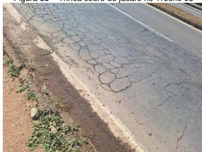
Figura 33 – Trinca couro de jacaré no Trecho 03
