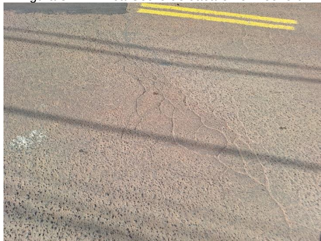
Figura 31 – Trinca Couro de Jacaré no Trecho 01
