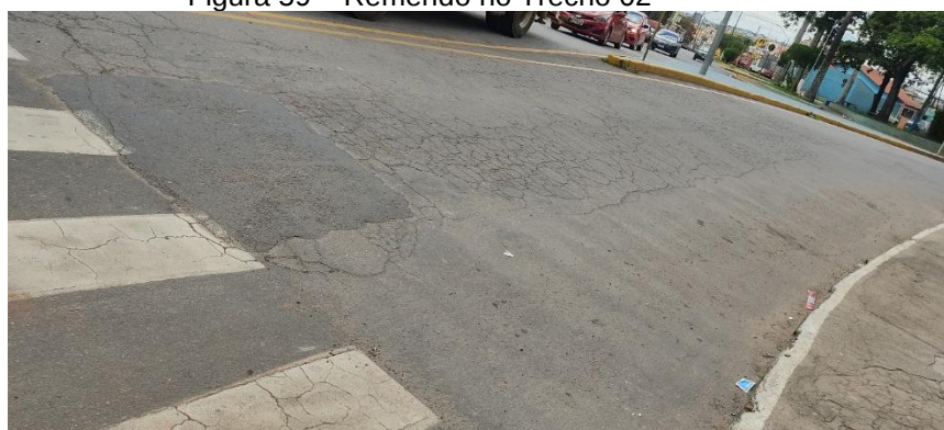
Figura 59 – Remendo no Trecho 02
