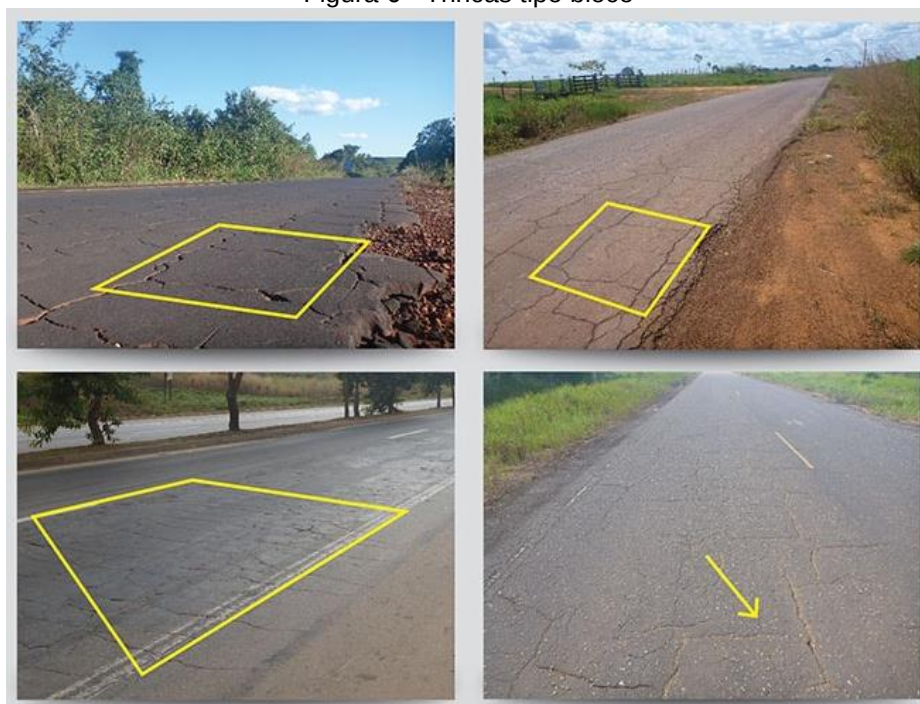
Figura 6 - Trincas tipo bloco
