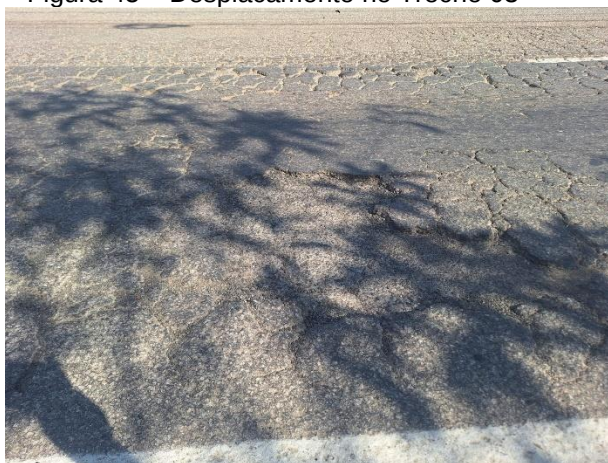
Figura 45 – Desplacamento no Trecho 03
