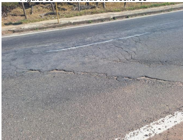
Figura 55 – Remendo no Trecho 03
