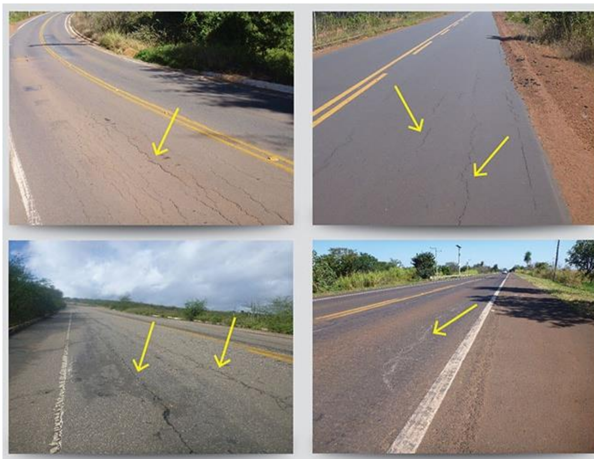
Figura 3 - Trincas Isoladas Longitudinais
