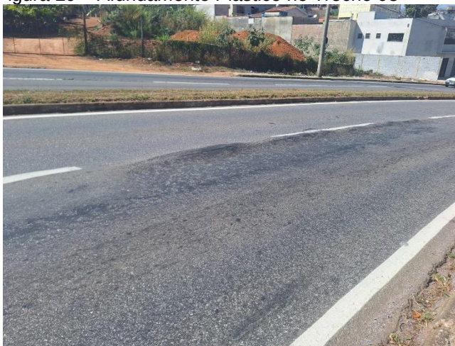
Figura 29 – Afundamento Plástico no Trecho 03
