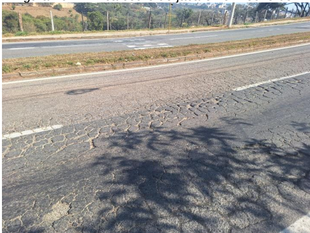
Figura 46 – Trinca couro de jacaré no Trecho 03
