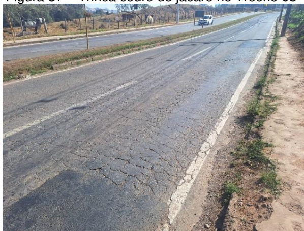
Figura 57 – Trinca couro de jacaré no Trecho 03
