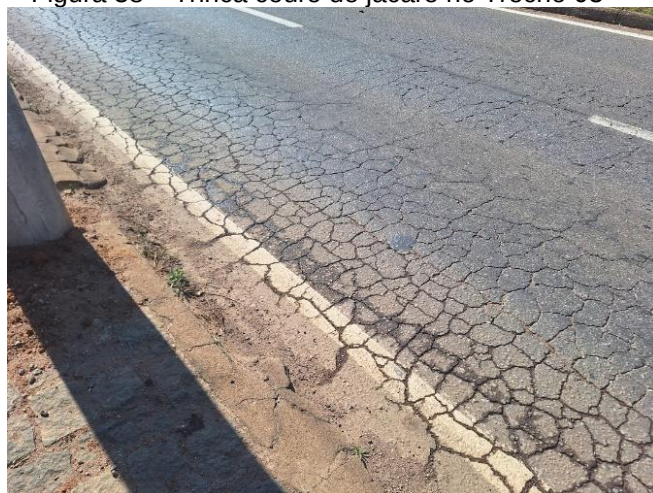
Figura 38 – Trinca couro de jacaré no Trecho 03
