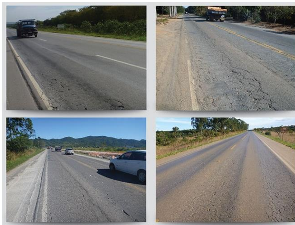
Figura 8 - Afundamento por consolidação
