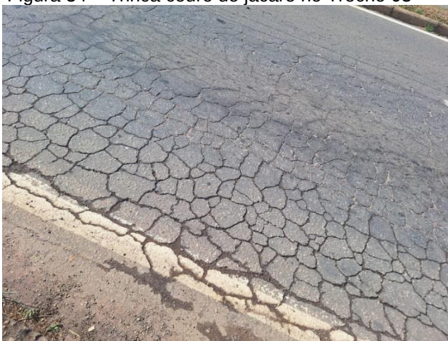
Figura 34 – Trinca couro de jacaré no Trecho 03
