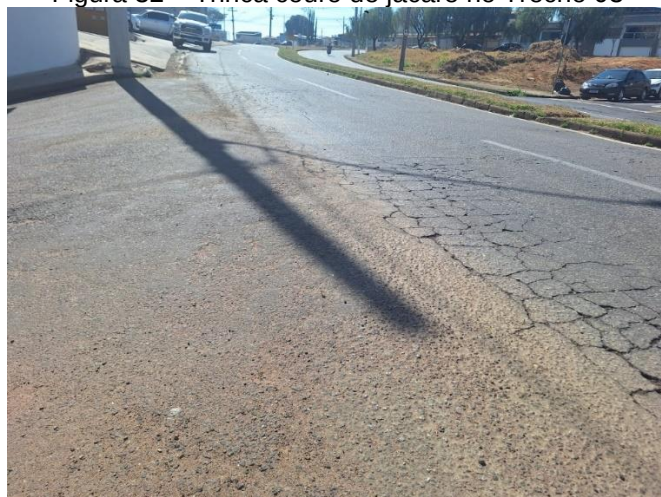
Figura 32 – Trinca couro de jacaré no Trecho 03
