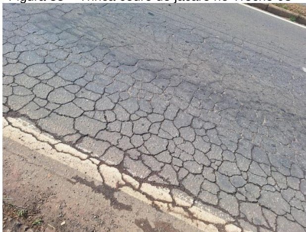
Figura 35 – Trinca couro de jacaré no Trecho 03
