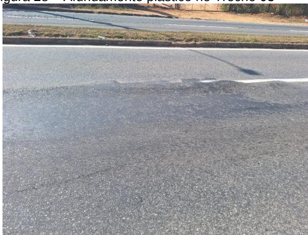
Figura 28 – Afundamento plástico no Trecho 03
