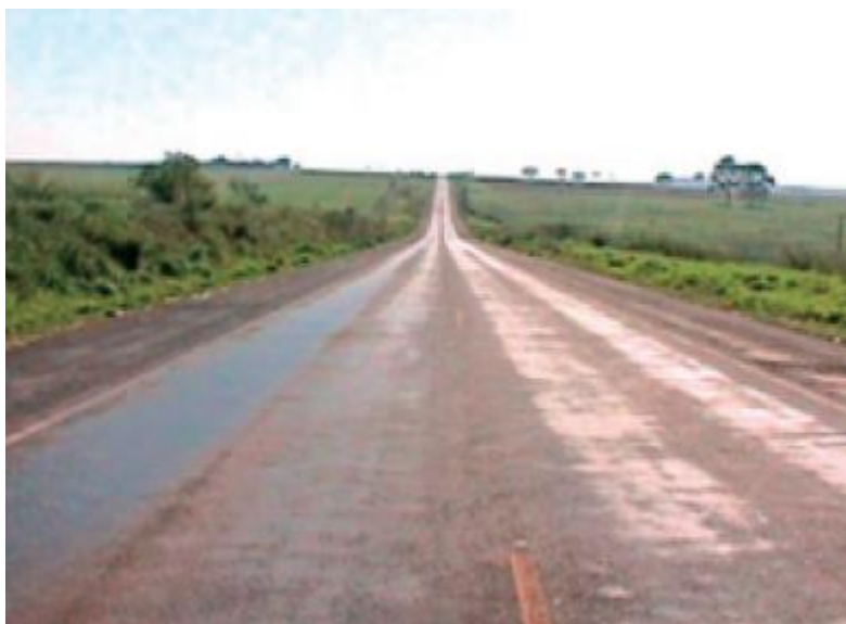
Figura 11 - Exsudação em Pavimento
