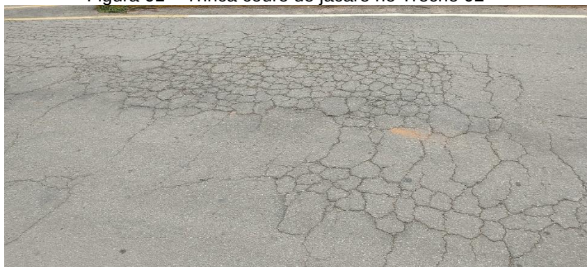
Figura 61 – Trinca couro de jacaré no Trecho 02
