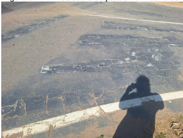
Figura 52 – Trinca couro de jacaré no Trecho 03
