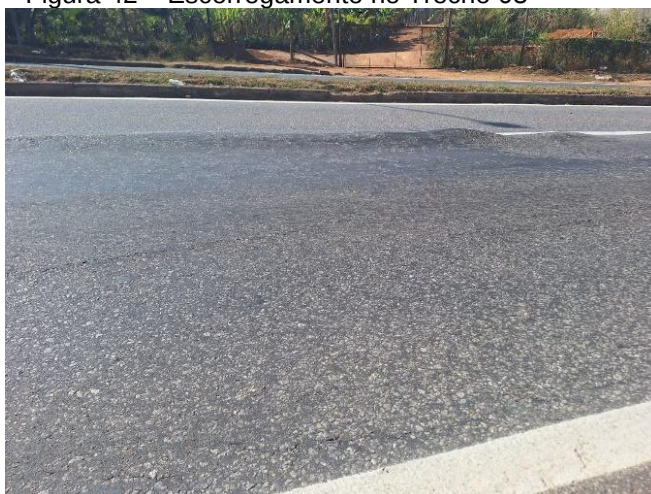
Figura 42 – Escorregamento no Trecho 03
