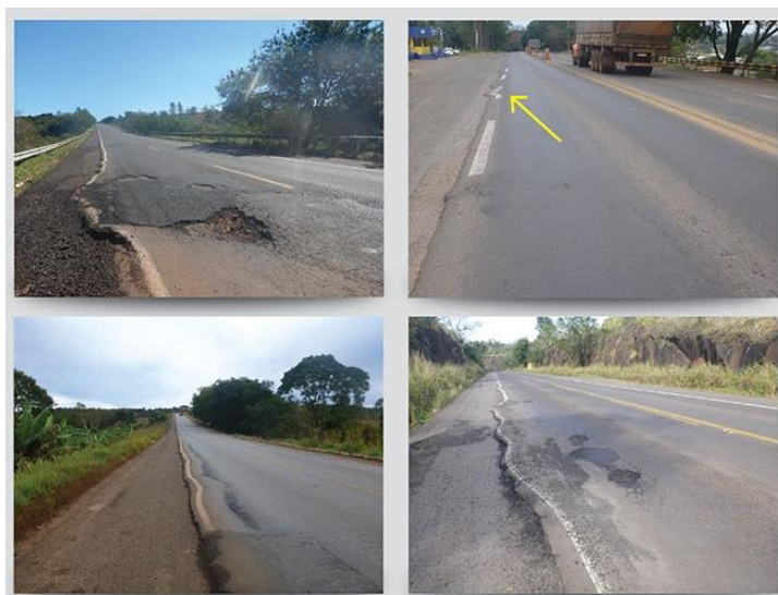
Figura 13 - Escorregamento em Pavimento
