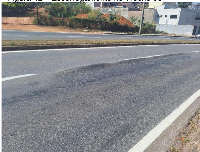
Figura 41 – Escorregamento no Trecho 03
