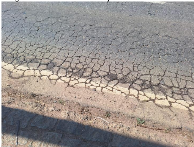
Figura 37 – Trinca couro de jacaré no Trecho 03
