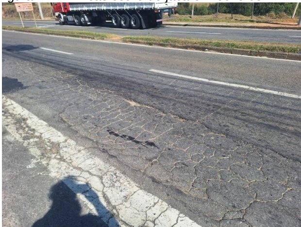
Figura 24 – Trincas couro de jacaré Trecho 03
