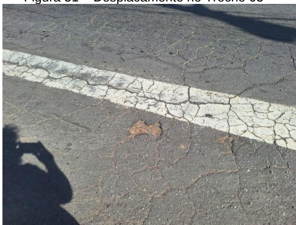
Figura 51 – Desplacamento no Trecho 03
