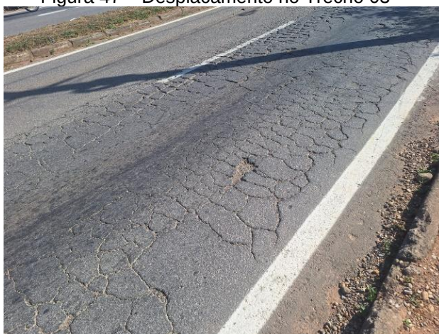
Figura 47 – Desplacamento no Trecho 03
