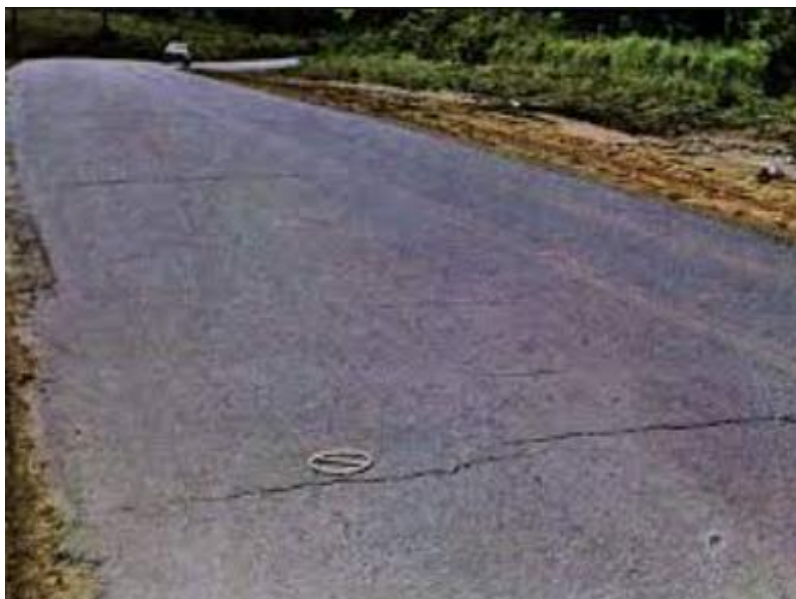
Figura 4 - Trinca Isolada Transversal
