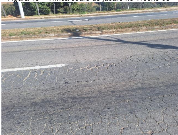
Figura 48 – Trinca couro de jacaré no Trecho 03
