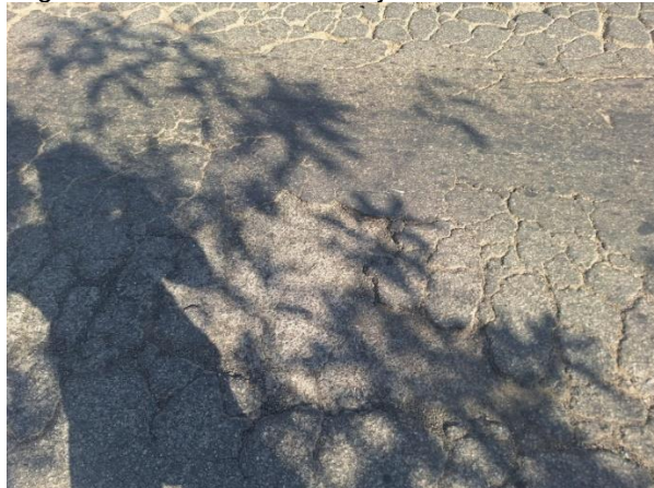
Figura 44 – Trinca couro de jacaré no Trecho 03
