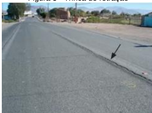
Figura 5 - Trinca de retração
