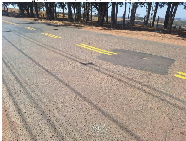
Figura 22 – Remendo no Trecho 01
