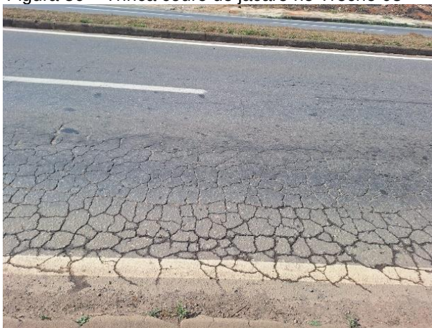
Figura 36 – Trinca couro de jacaré no Trecho 03
