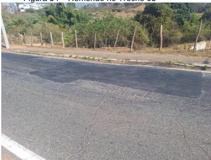
Figura 54 – Remendo no Trecho 03
