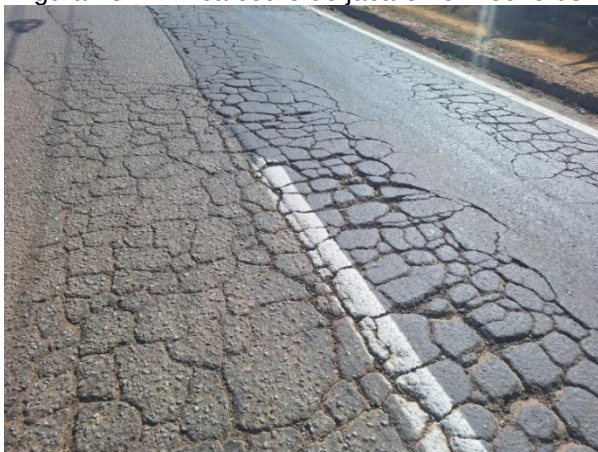
Figura 43 – Trinca couro de jacaré no Trecho 03
