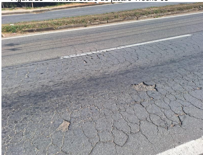
Figura 23 – Trincas couro de jacaré Trecho 03
