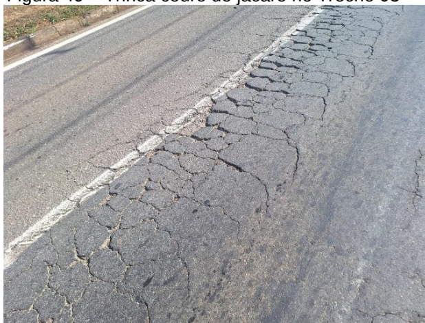
Figura 49 – Trinca couro de jacaré no Trecho 03
