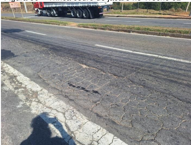
Figura 50 – Trinca couro de jacaré no Trecho 02
