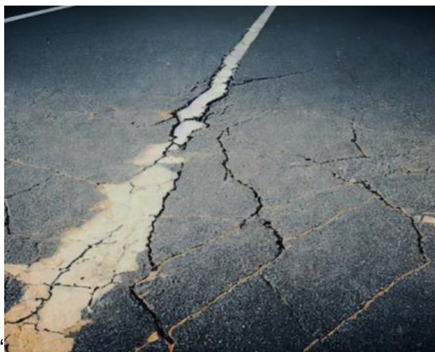
Figura 7 – Fissuras na Pavimentação
