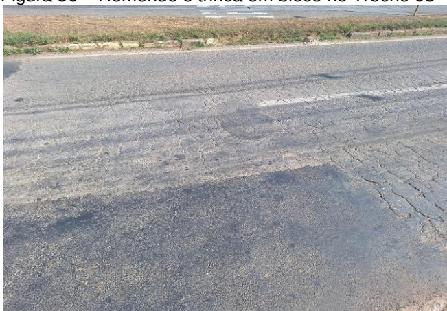
Figura 56 – Remendo e trinca em bloco no Trecho 03
