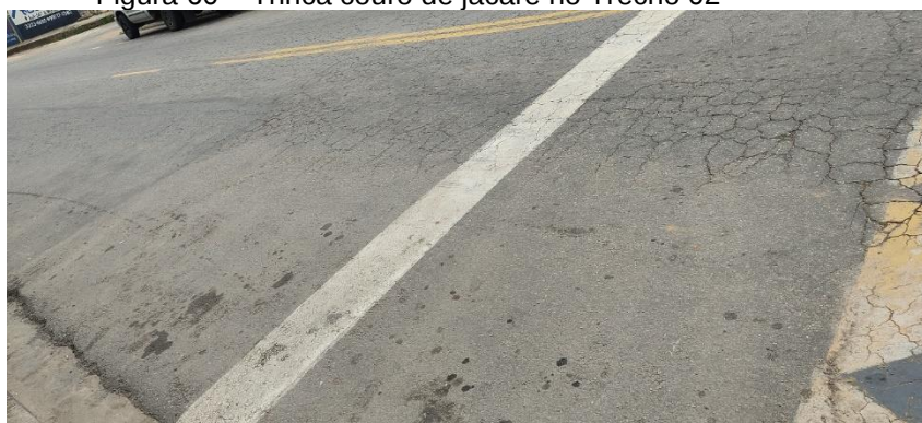
Figura 60 – Trinca couro de jacaré no Trecho 02
