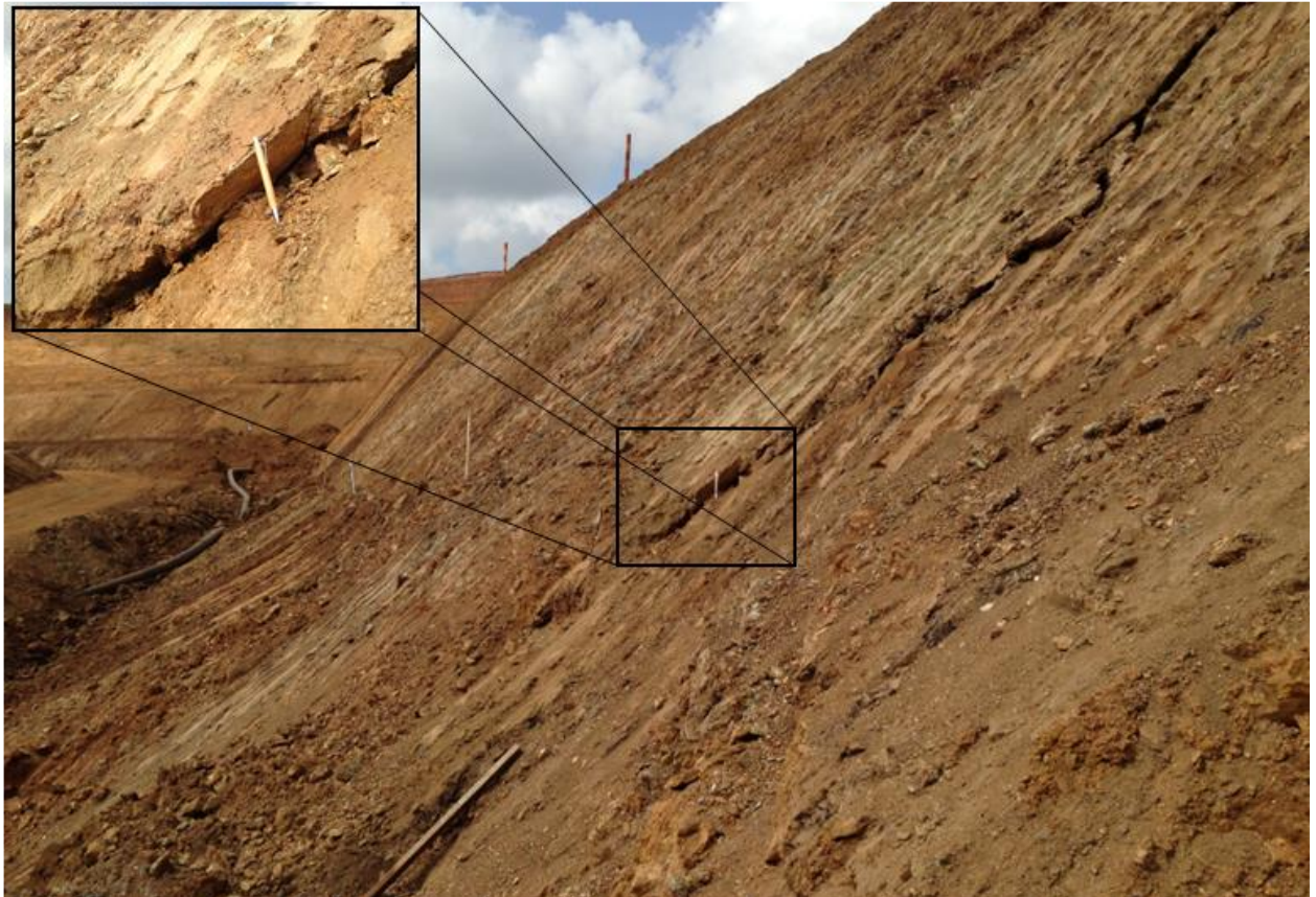
Figura 48 - Detalhe do talude durante o rompimento, devida a presença de Flogopitito Alterado.
