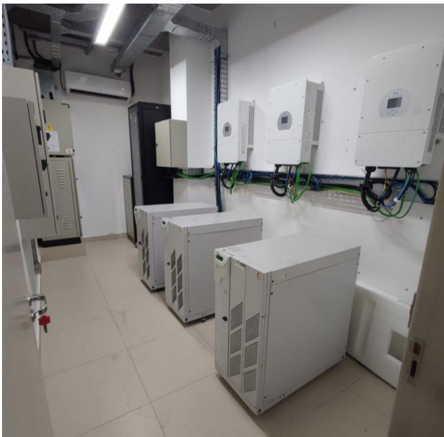
Figura 3 – Vista interna da central elétrica do data center do CEFET-MG
