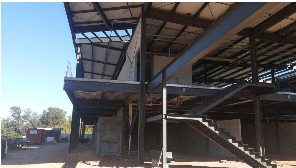
Figura 19 – Falta de tela tapume na área total externa do mezanino
