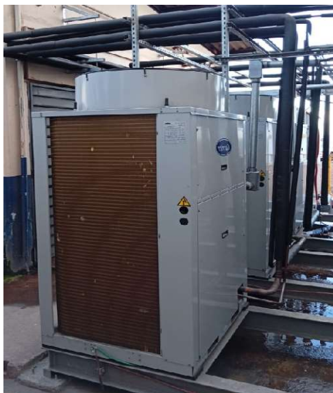
Figura 13 – Unidades condensadoras VRF instaladas em área externa, sistema similar ao adotado no projeto
