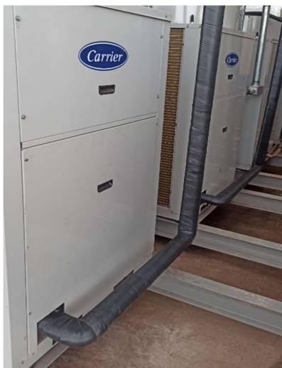
Figura 18 – Linha frigorígena de cobre do sistema VRF, tubulação de líquido e sucção com isolamento termoacústico
