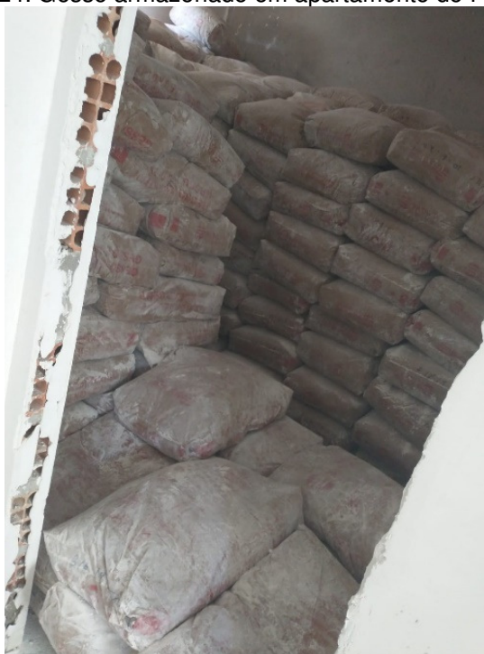
Figura 24: Gesso armazenado em apartamento do Park Sion
