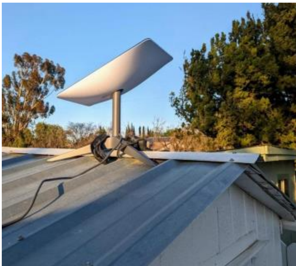
Figura 14 – Imagem da antena instalada
