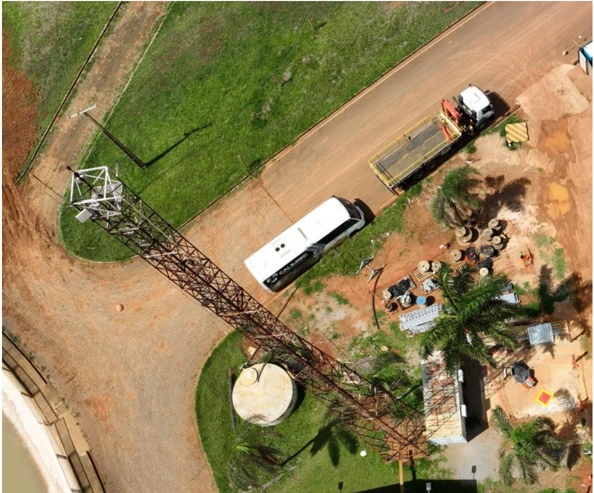
Figura 19 - Estação base de recepção e transmissão GNSS.
