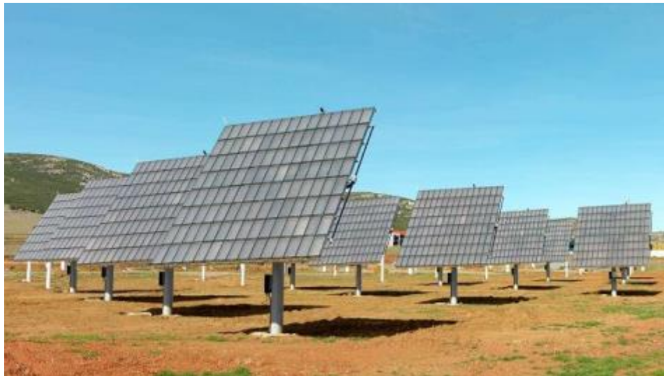
Figura 4 – Exemplo de um sistema HCPV instalado nos terrenos do ISFOC em Puertollano, Espanha ano de 2008.
