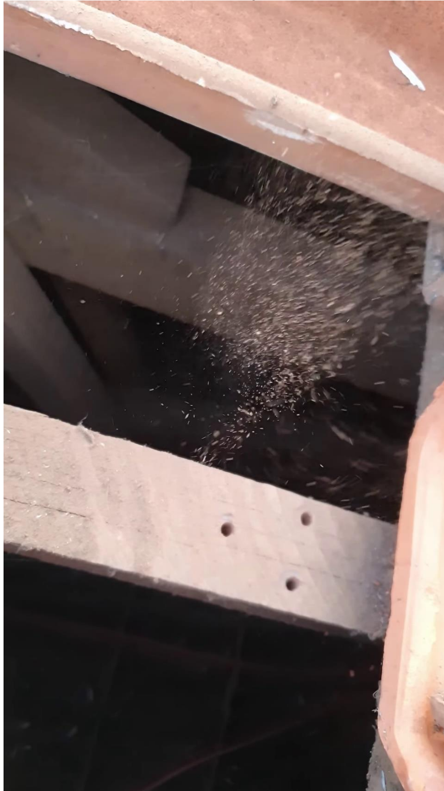
Figura 28 – Furos nas vigas de madeira.
