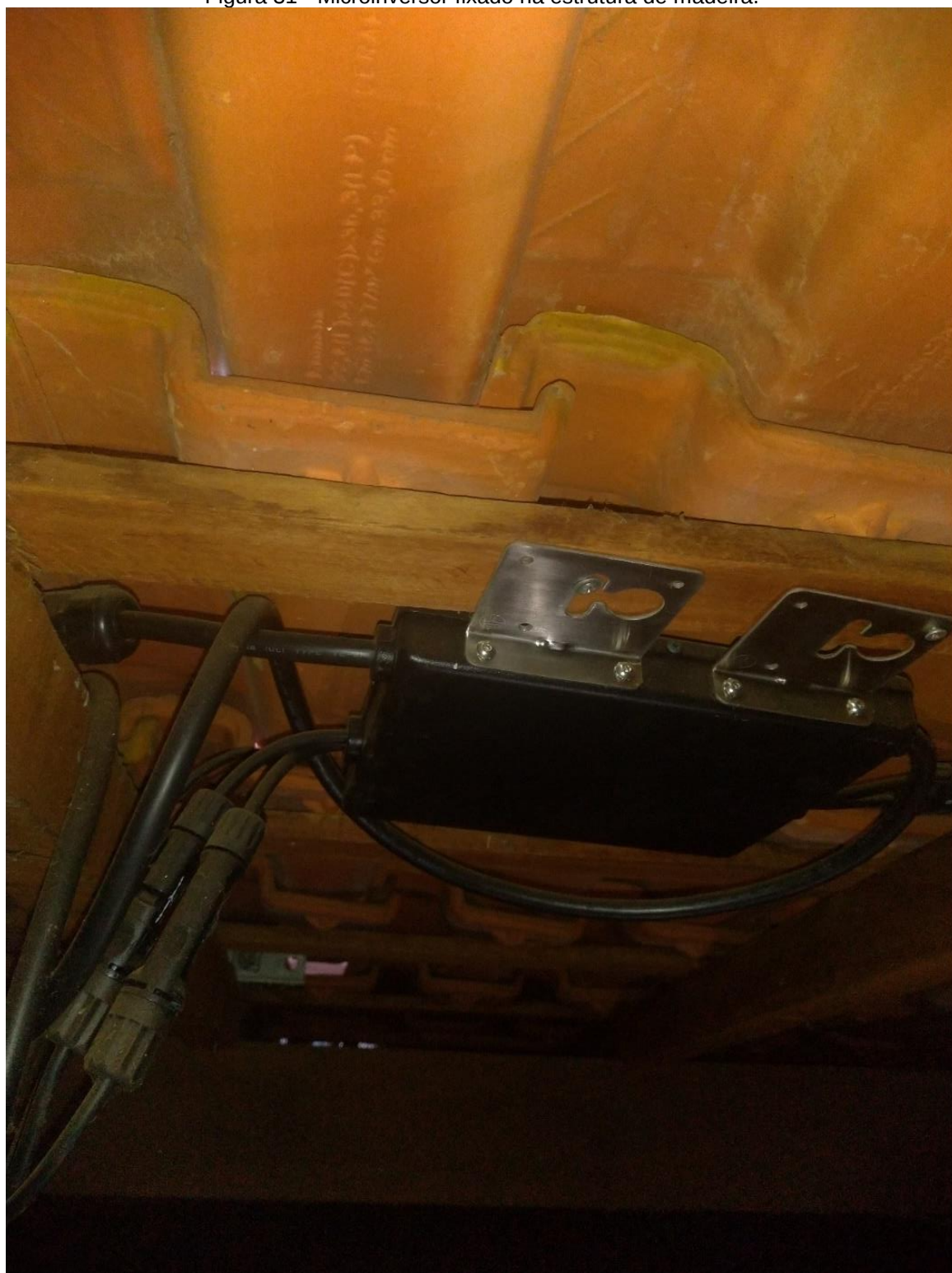
Figura 31 - Microinversor fixado na estrutura de madeira.
