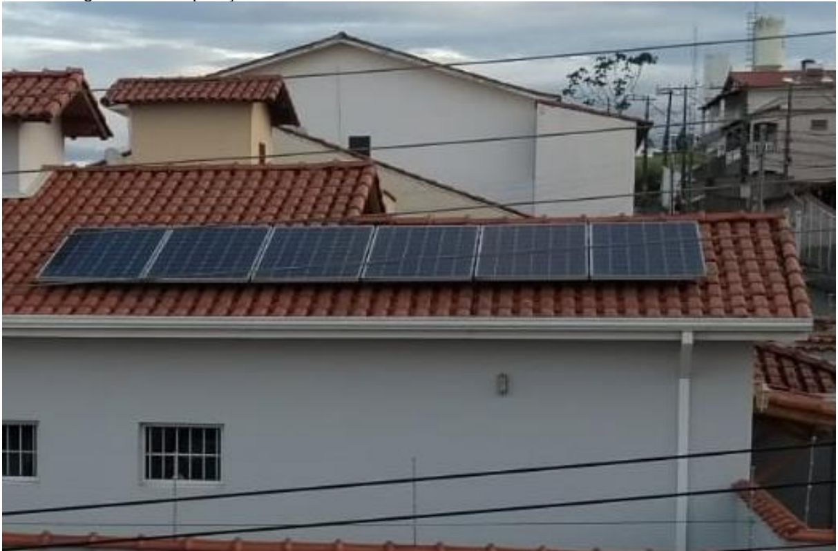
Figura 30 – Disposição dos módulos fotovoltaicos instalados no telhado da residência.
