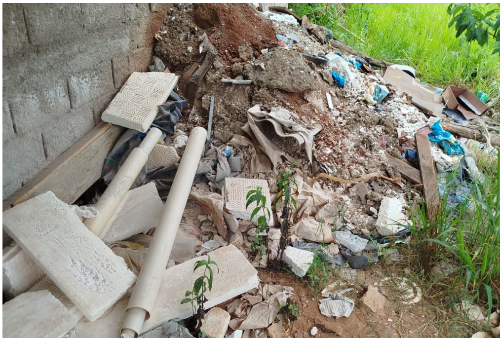
Figura 17: Resíduos de Construção Civil no Bairro Jardim Bárbara Heliodora.
