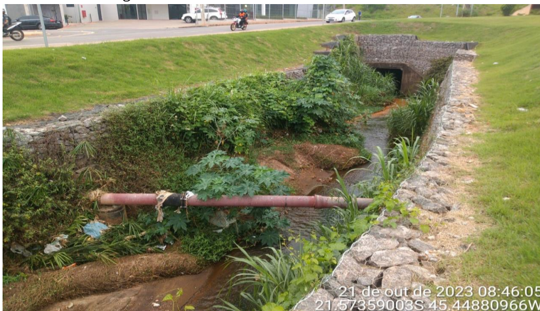
Figura 36: Acúmulos de sedimentos no Trecho III.
