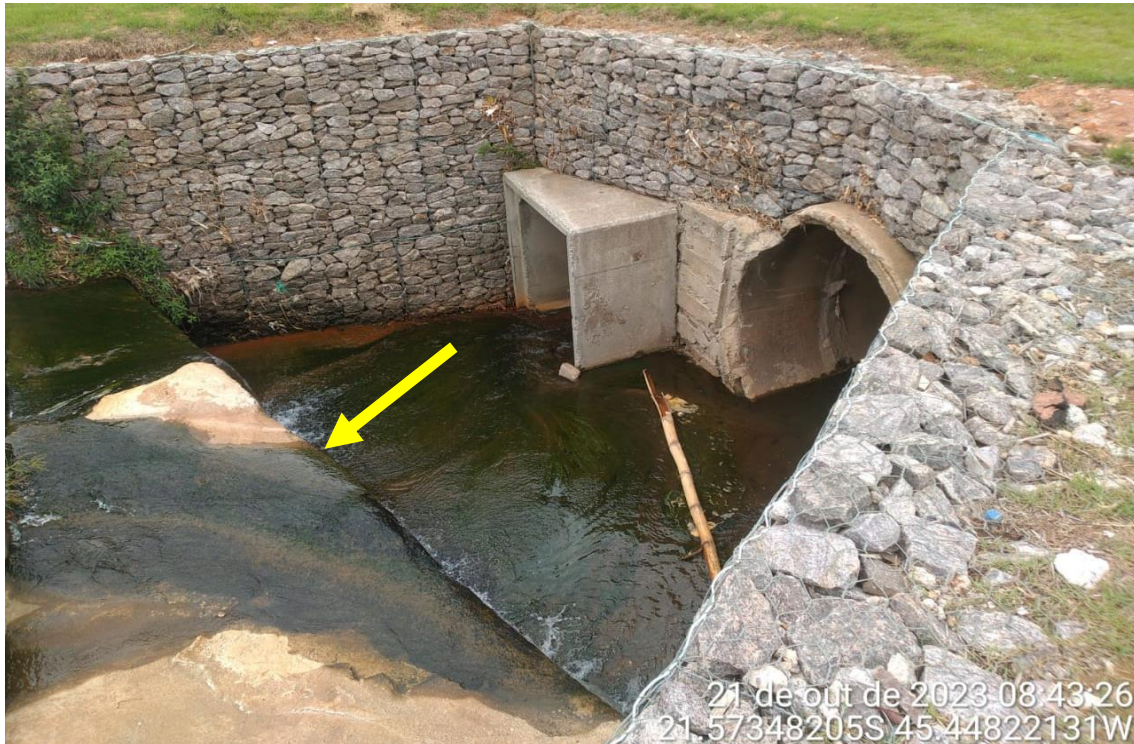
Figura 46: Degrau presente próximo à entrada dos bueiros.
