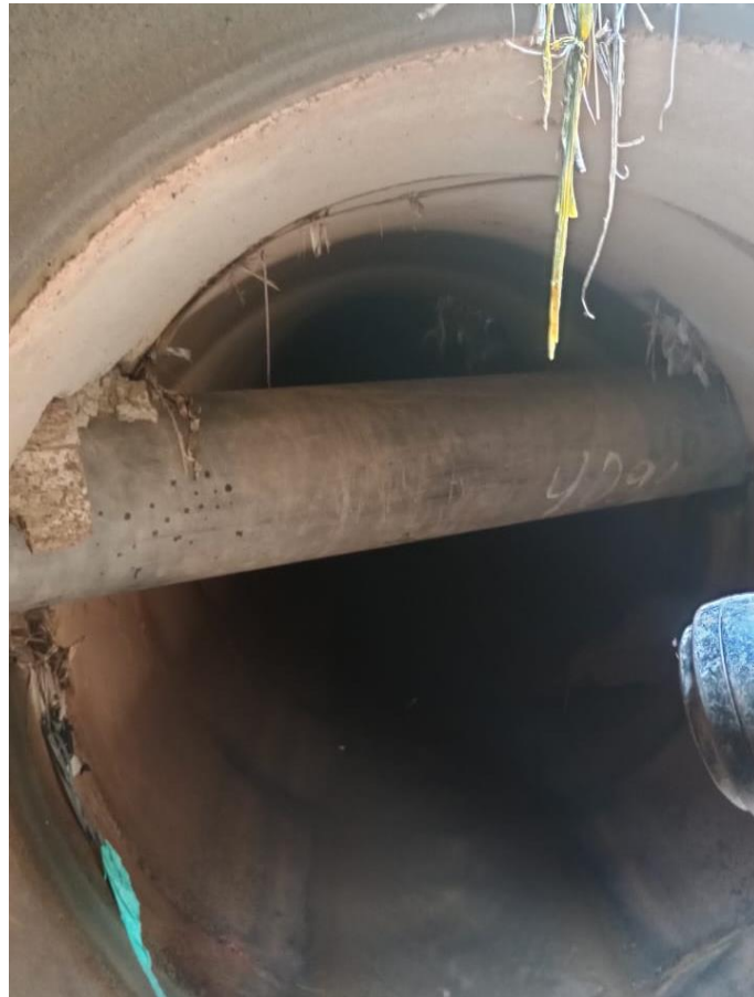
Figura 37: Interferência de rede de esgoto em galeria de água pluvial (Trecho I).
