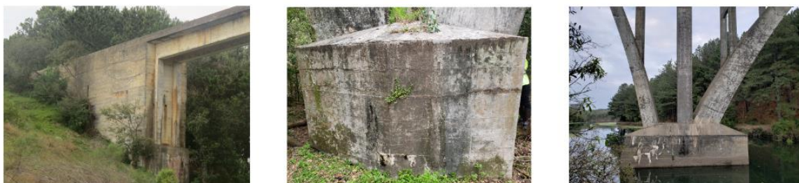
Figura 20 – Manifestações patológicas da infraestrutura
