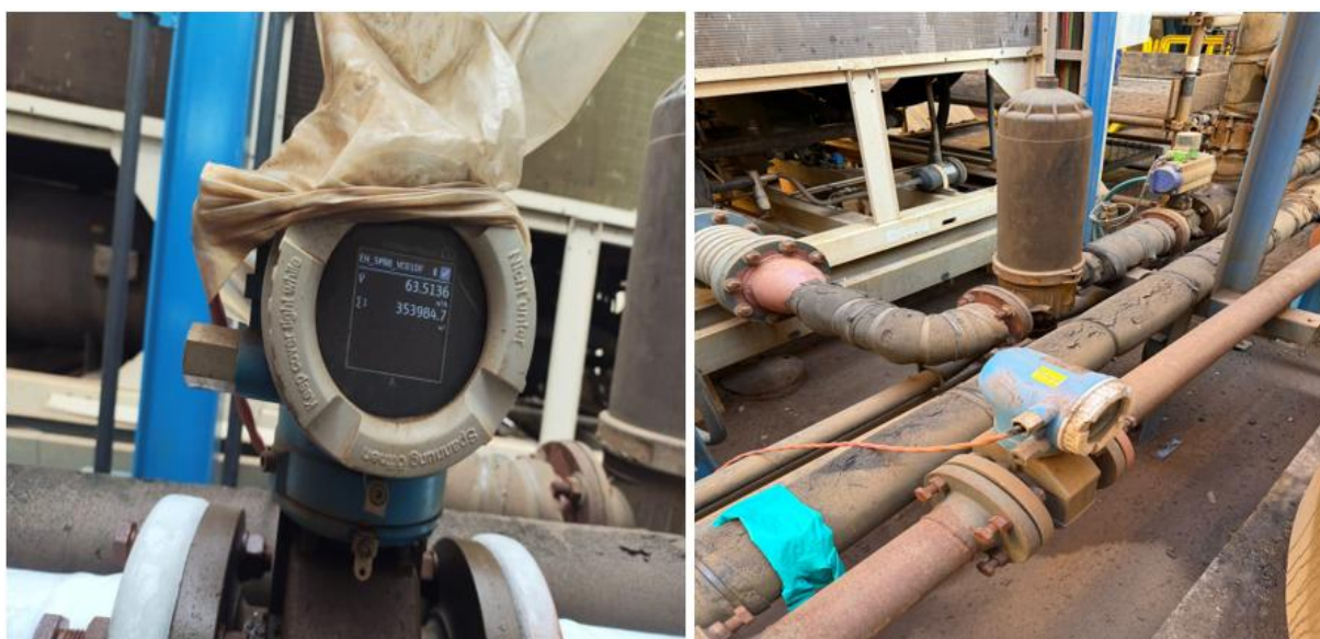
Figura 12 - Transmissor de Vazão
