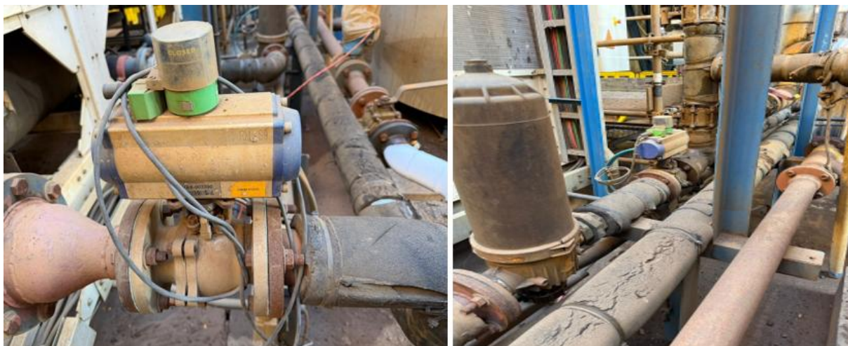
Figura 16 – Válvula/ Atuador Pneumático
