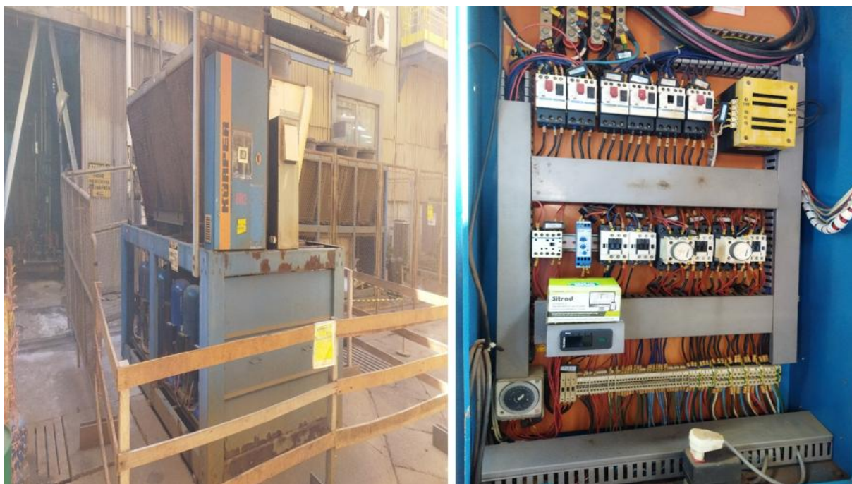
Figura 4 - RF-02 (Sem Automação e com Compressores Scroll)
