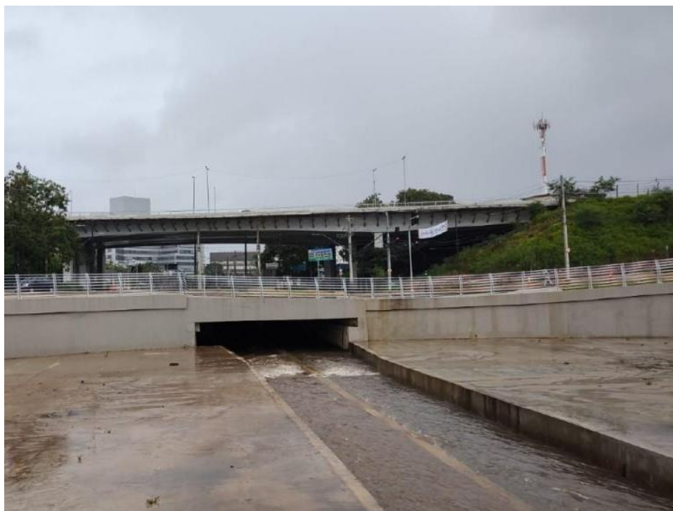
Figura 9- Caixa de captação do córrego Vilarinho
