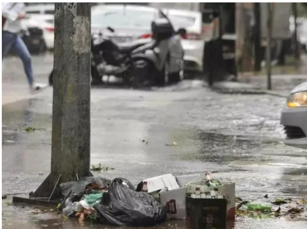
Figura 13- boca de lobo cheia de resíduos, Belo Horizonte, 2022
