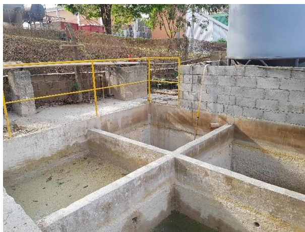
Figura 27– Armazenamento da água
