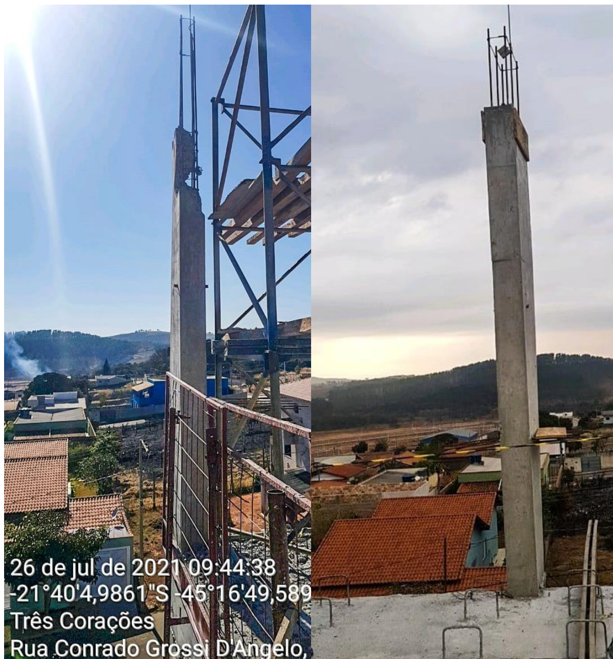
Figura 56 – Pilares fora de esquadro
