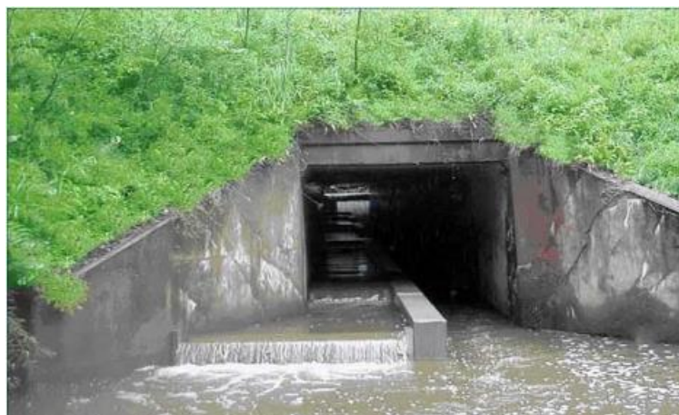
Figura 22 - Bueiro para passagem de peixes.
