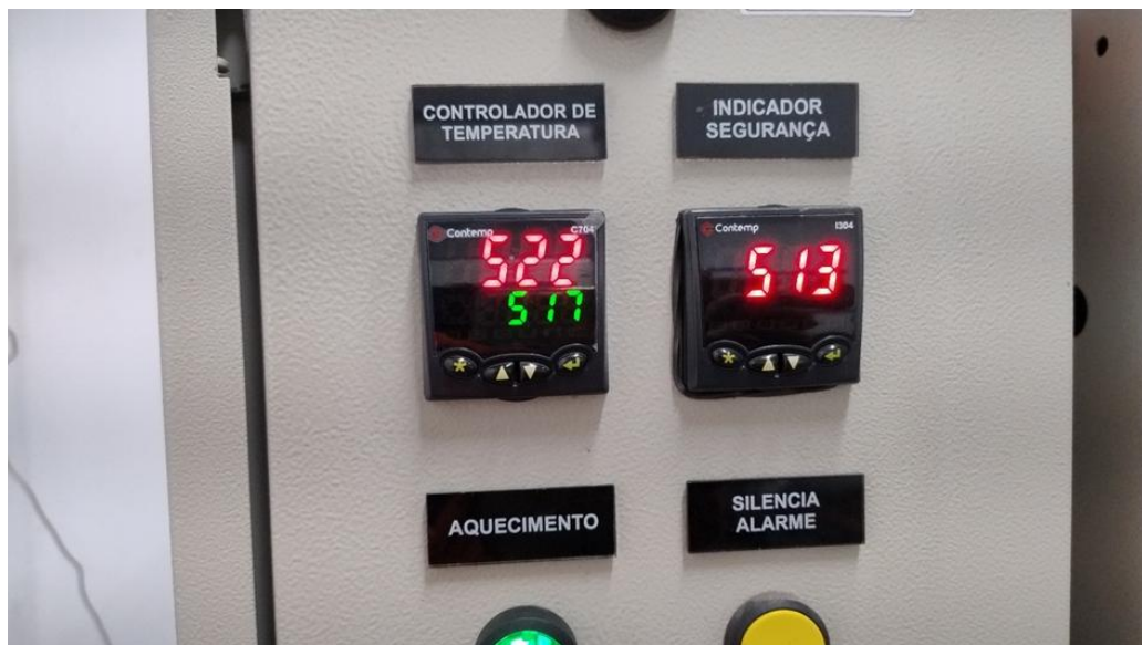
Figura 16 - Painel de controle do forno.
