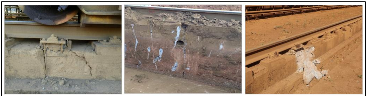
Figura 2-7: Evidência das trincas e rachaduras da base civil dos trilhos da Empilhadeira (Stacker). Fonte: Autor (2024).
