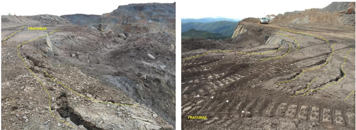
Figura 5 - Instabilidades geotécnicas em taludes de cavas (área de estudo)
