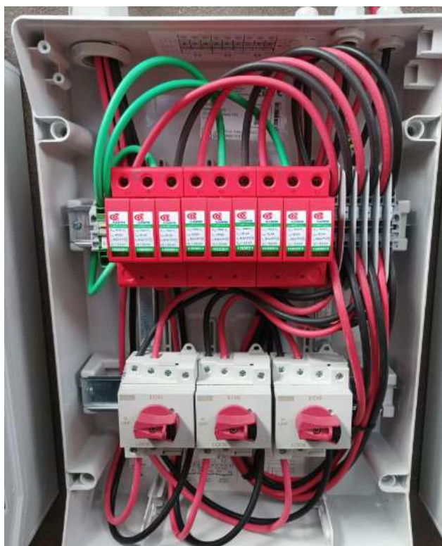
Figura 24: Quadro de distribuição QDCC fotovoltaico
