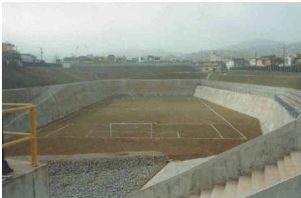
Figura 17 – Reservatório de retenção a céu aberto, São Bernardo do Campo.
