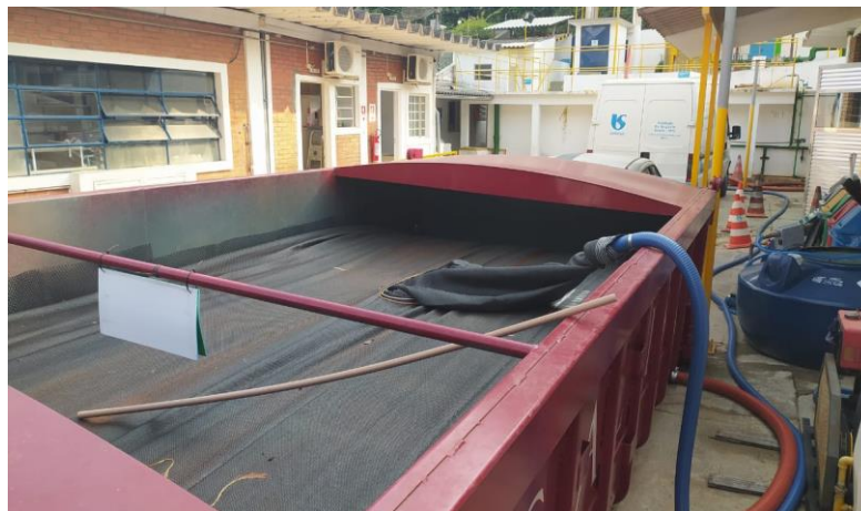
Figura 25 - SCR móvel, central de condicionamento químico e decantador
