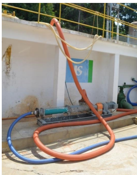
Figura 26 - Bomba helicoidal e tubulações de sucção e recalque
