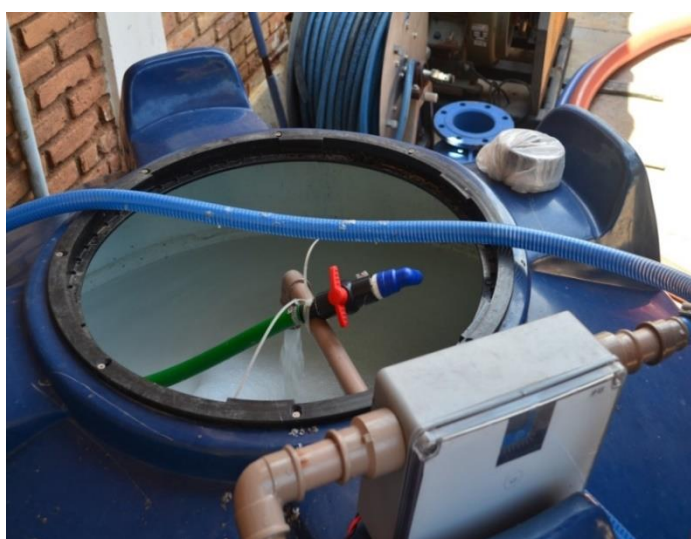
Figura 28 - Central de condicionamento químico
