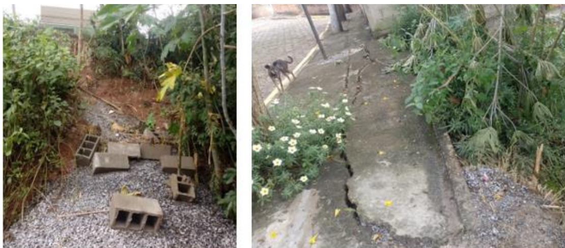
Figura 6: Corte talude presente ao lado da casa situada na Rua Emerenciana Cândida de Jesus, nº 64, bairro Santa Tereza, Caxambu-MG.
