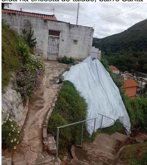
Figura 4: Casa construída na encosta do talude, bairro Santa Tereza, Caxambu-MG.
