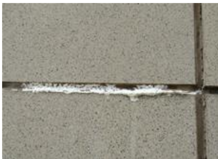
Figura 18 - Presença de eflorescência no rejuntamento.
