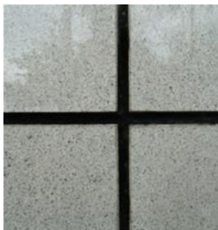
Figura 19 - Presença de fungos no rejuntamento.
