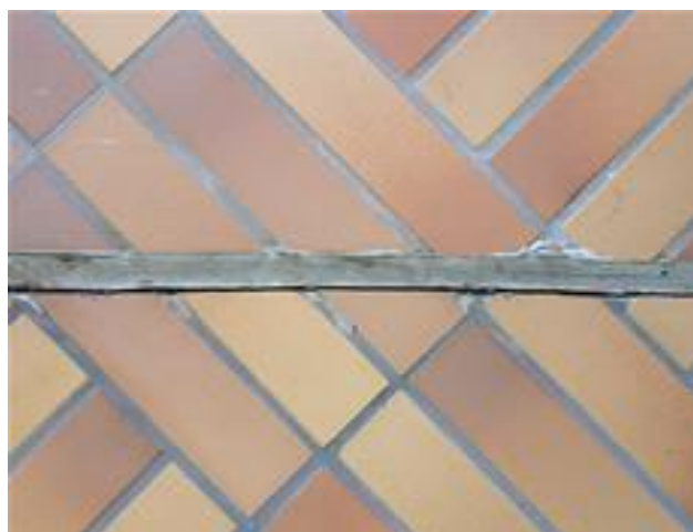
Figura 20 - Falha no selante da junta de movimentação.
