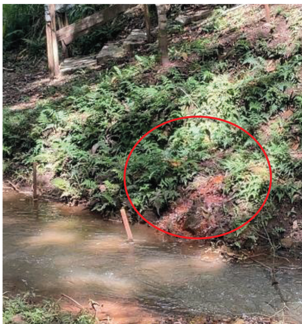
Figura 14 – Exemplo real de surgência no pé do aterro do talude.
