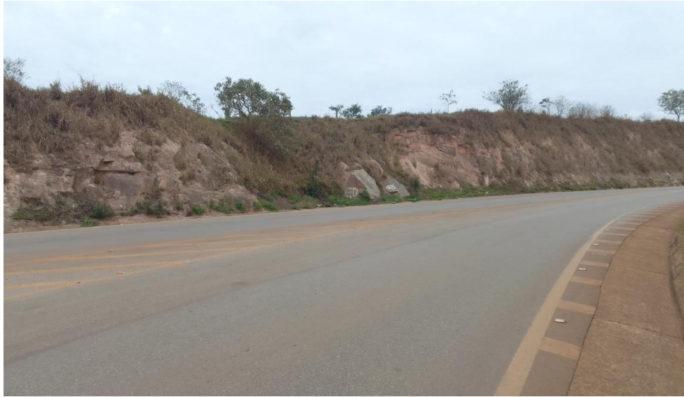
Figura 18-Vista de talude de corte esquerdo com formação rochosa.
