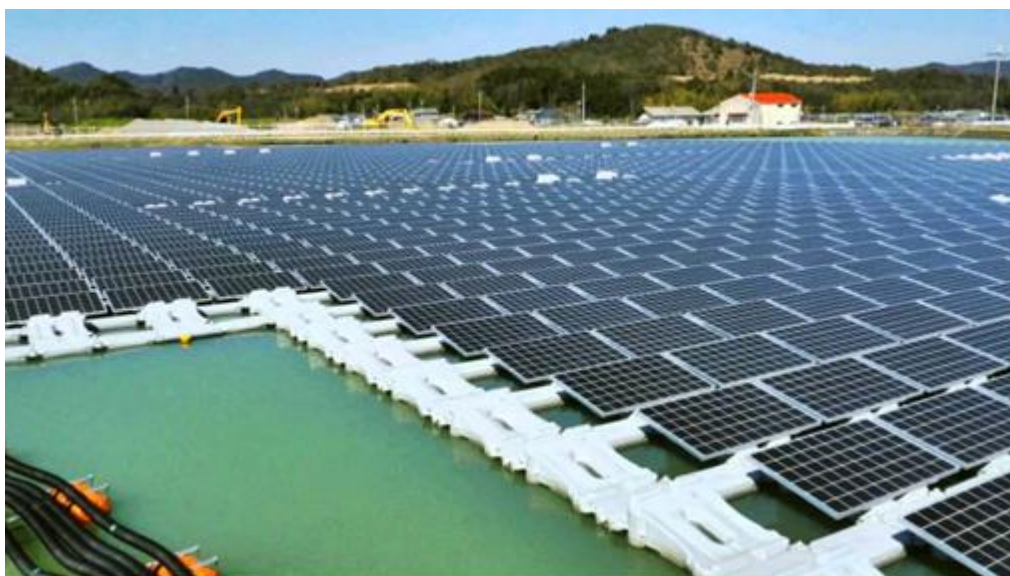
Figura 7 - Usina Solar Fotovoltaica Flutuante
