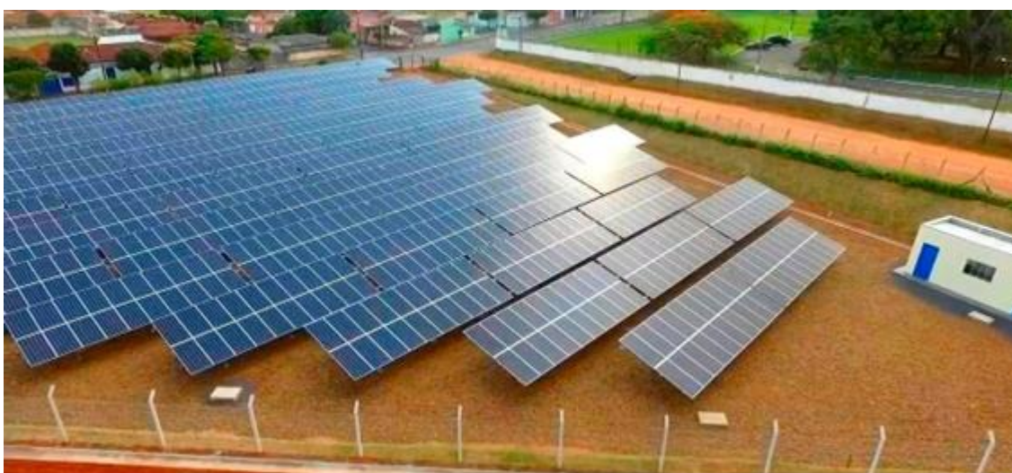
Figura 6 - Usina Solar Fotovoltaica de Geração Centralizada
