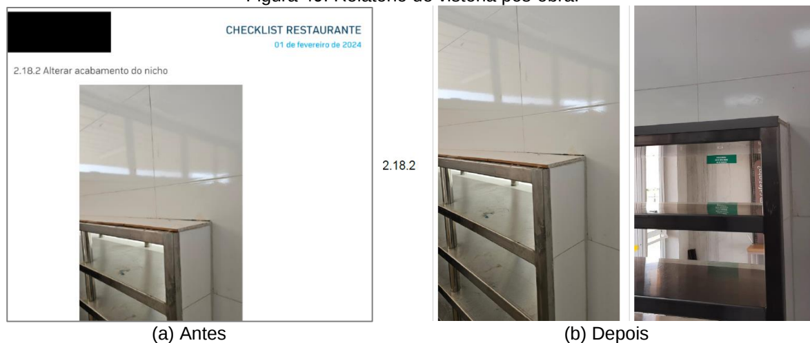
Figura 49: Relatório de vistoria pós-obra.
