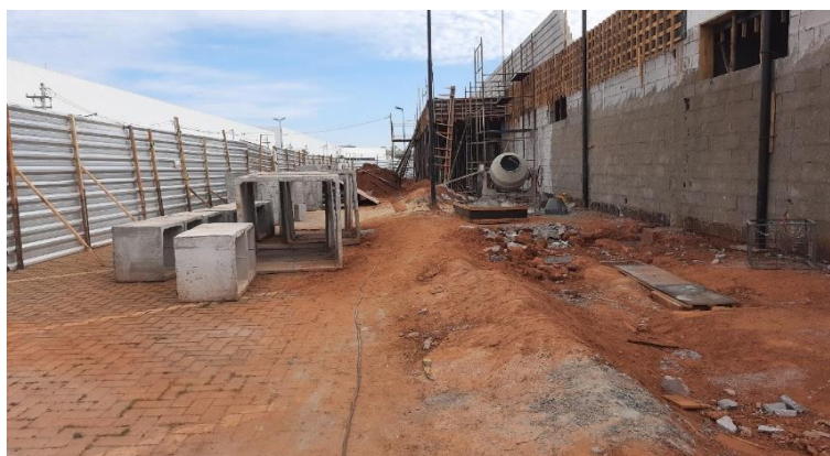
(a) Caixas de passagem.
