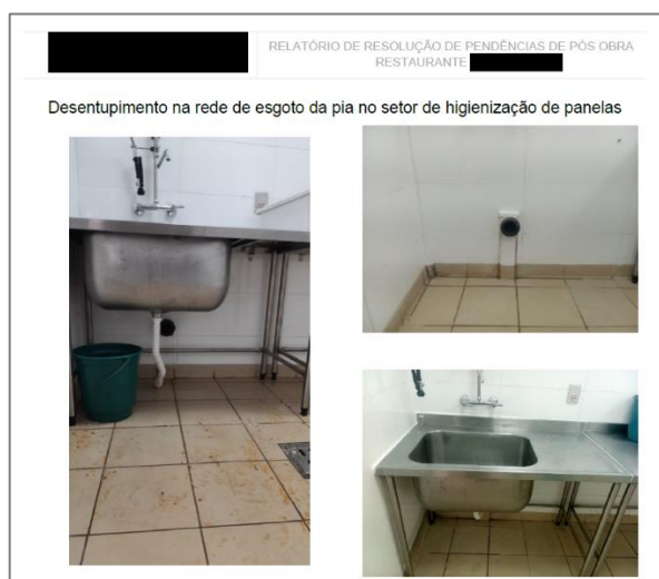
Figura 51: Situação de pós-obra com acionamento de garantia.
