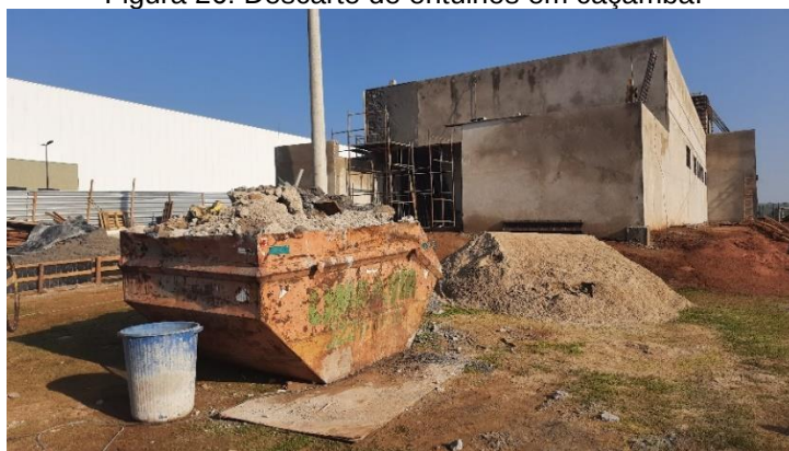
Figura 26: Descarte de entulhos em caçamba.
