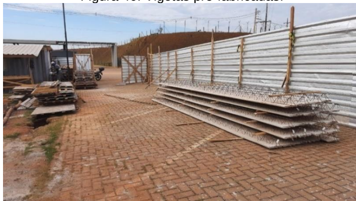
(a) Armazenamento provisório não conforme.
