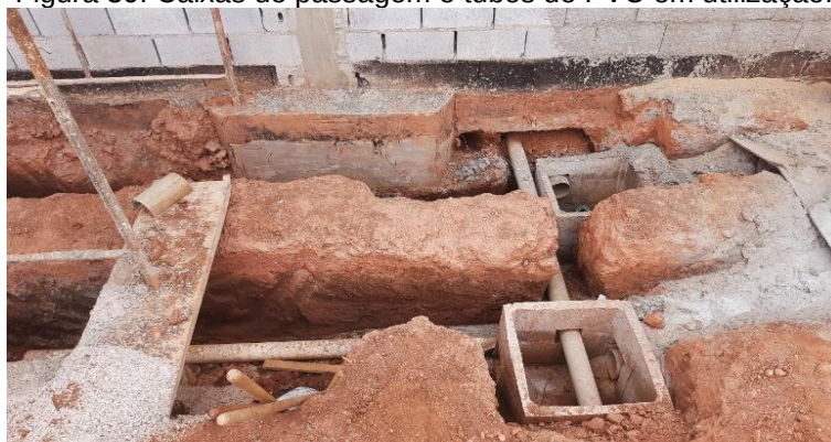
Figura 39: Caixas de passagem e tubos de PVC em utilização.
