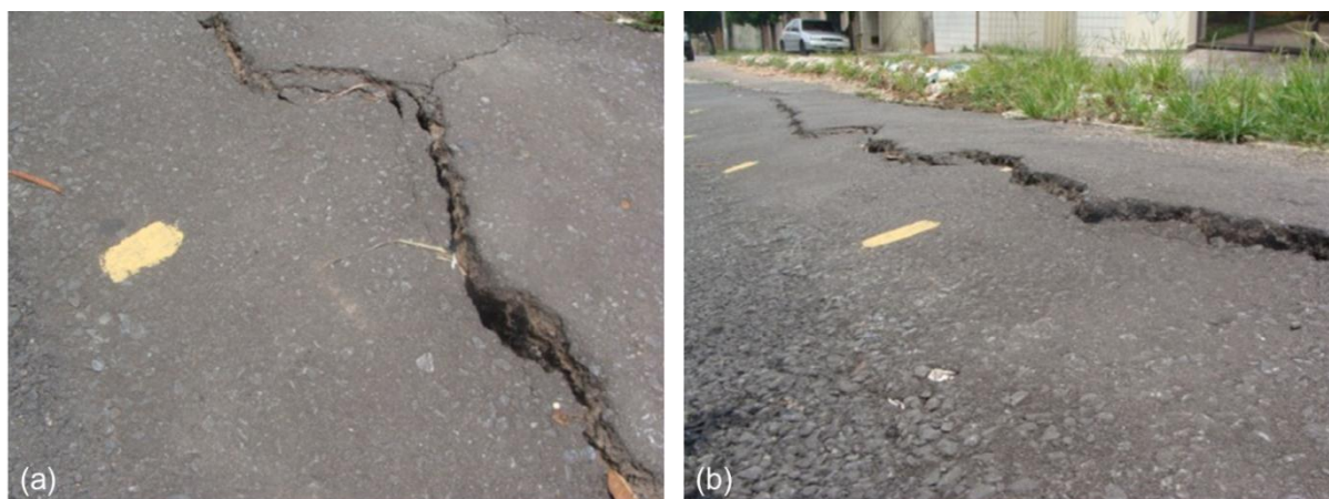
Figura 9: Vista aproximada da rachadura existente na calçada: (a) abertura crítica de 4 cm; (b) evidências de deslocamento do maciço terroso com diferença de altura de 2 cm.
