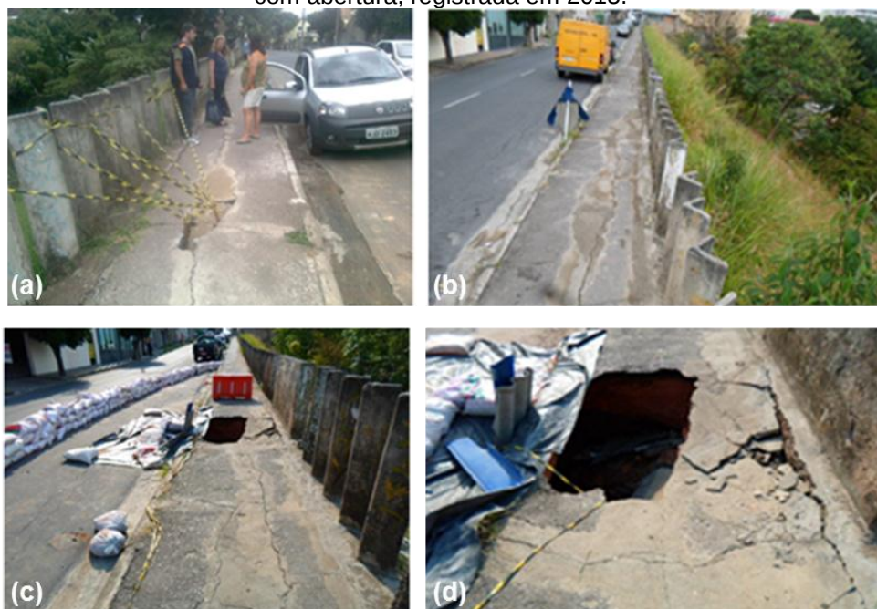
Figura 7: Problemas recorrentes na área de estudo: (a) Trincas no pavimento e danos na calçada, registradas em 2012; (b) Trincas em alguns pontos do pavimento e da calçada, registradas em 2015; (c) Trincas no pavimento e abertura na calçada, registradas em 2015; (d) Vista do trecho da calçada com abertura, registrada em 2015.
