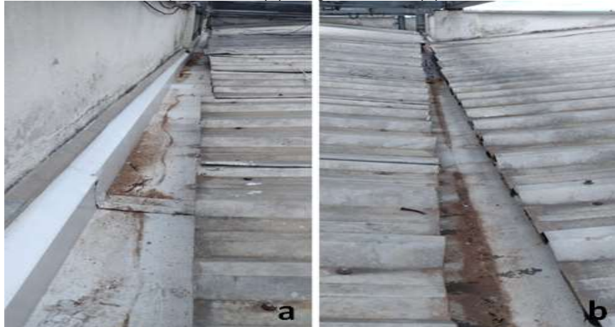
Figura 28 – Calhas de platibanda (a) e água furtada (b) instaladas na edificação
