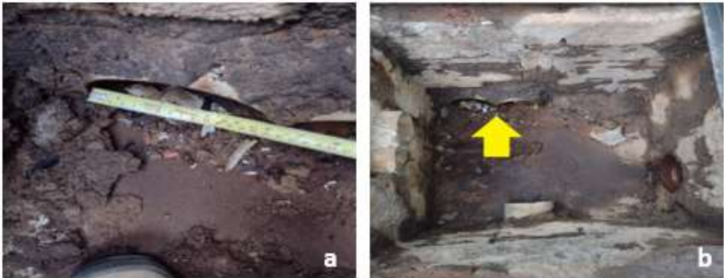
Figura 32 – Diâmetro (a) e caixa de passagem (b) dos condutores horizontais da edificação
