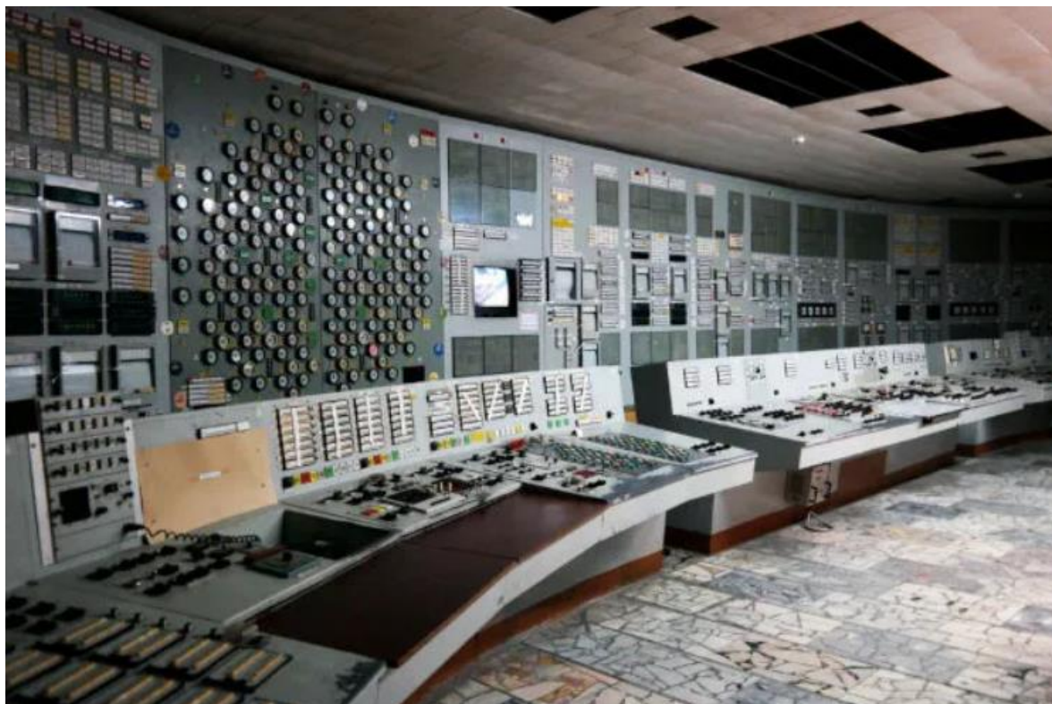
Figura 1 – Painel de controle e supervisão da Usina Nuclear de Chernobyl
